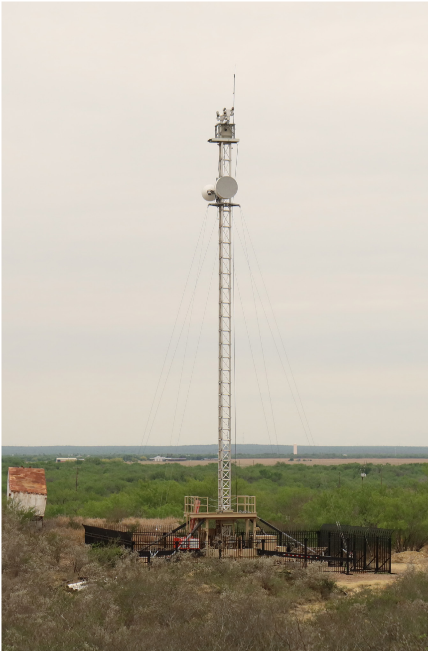
RVSS reubicable a lo largo del Río Bravo, en el sur de Texas. Fuente: EFF.
